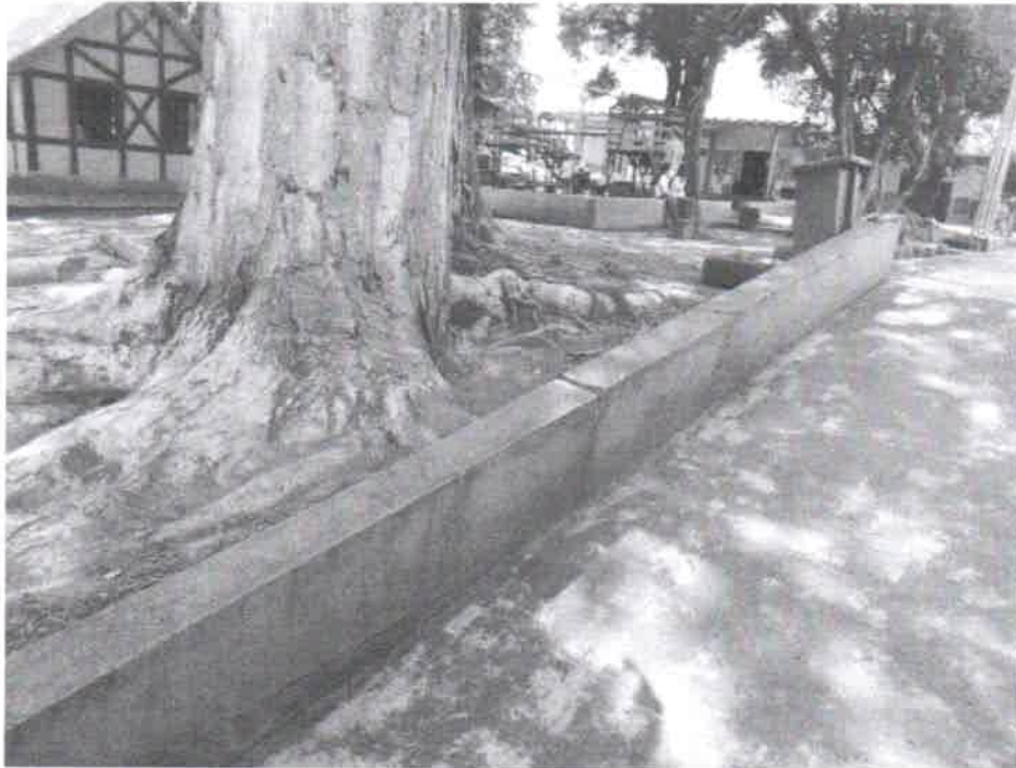
FOTOS 10,11,12 DESTAQUE DAS RAIZES DAS ARVORES DE GRANDE PORTE NO PARUQUE AFETANDO A ESTRUTURA DO MUROS.
