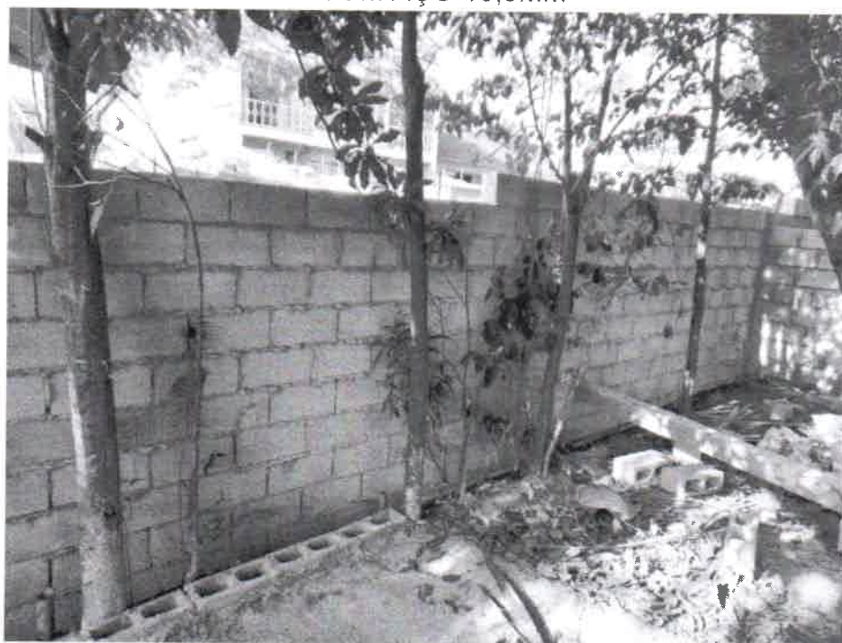
FOTO 09 DESTAQUE MÃO FRANCESAS NO MURO DE ARRIMO PARTE INTERNA PARQUE E PARTE EXTERNA ALAMEDA PRINCESA ISABEL.
