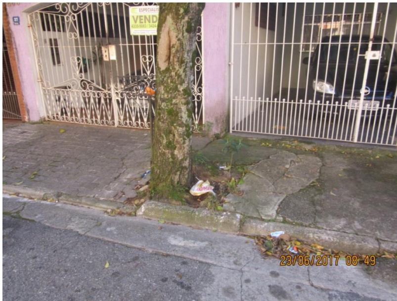
Fotos 1 a 2 – Rua Tota Nogueira, 256 – Assunção – Subst. – PASB 30421-2017-45
